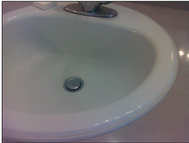
Ensuite sink plugged
