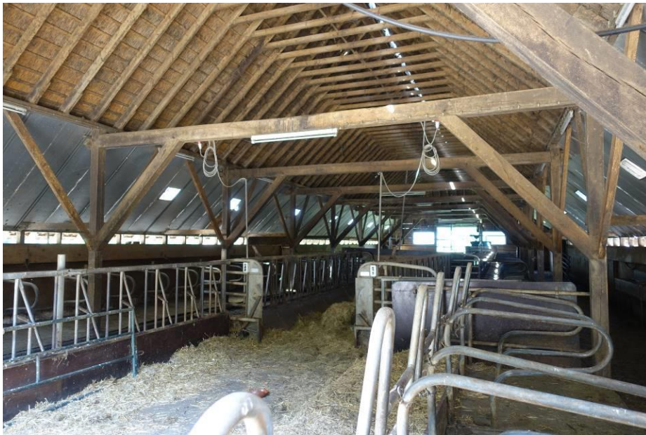
De in 1977 gebouwde en in 1996 inwendig verbouwde voerboxenstal heeft nog traditionele ankerbalkgebinten met gehakte telmerken.
