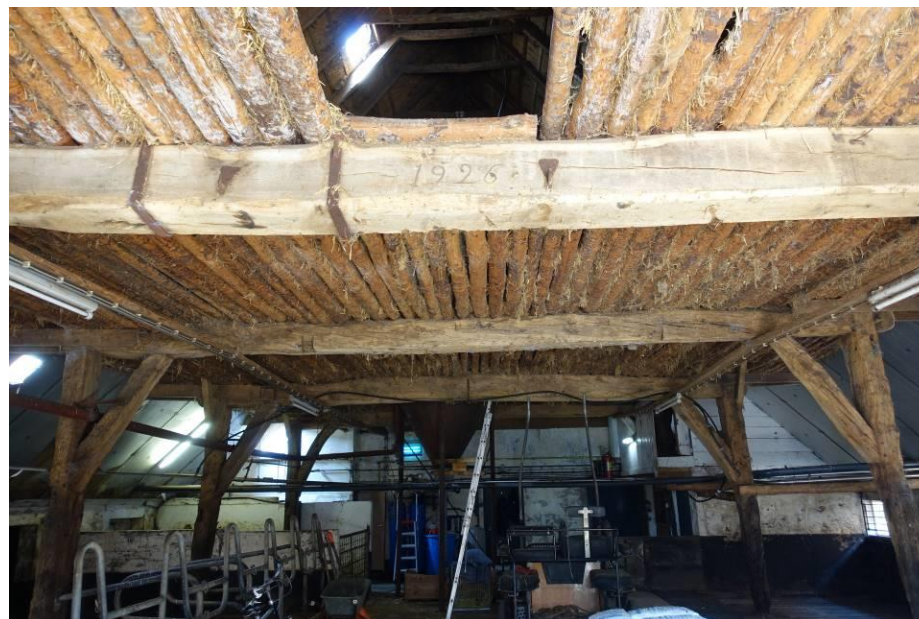
Zicht in de deel richting westen, met op de voorgrond de ankerbalk met het jaartal 1926 ingekerfd.
