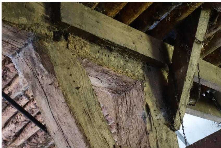
Telmerken bestaande uit vier gegutste ovaaltjes op de ankerbalk, stijl en korbeel van gebint 4.
