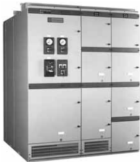
DSII Switchgear Assembly
