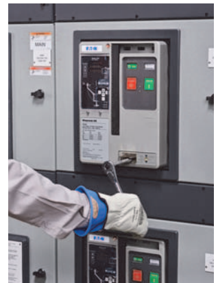
Levering Magnum DS Breaker
