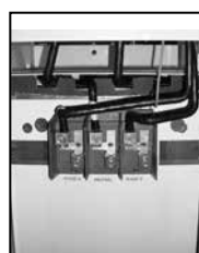
Utility lug landing
