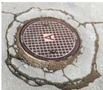
Skador runt brunnsbetäckning
