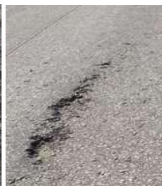
Mindre skada i asfalten
