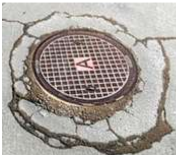
Skador runt brunnsbetäckning
