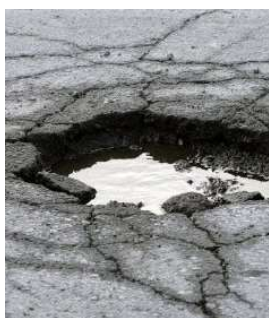
Potthål/slaghål i gatan kan orsaka stor skada och höga kostnader
