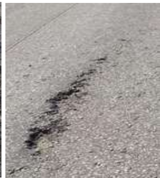
Mindre skada i asfalten
