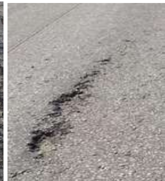
Mindre skada i asfalten
