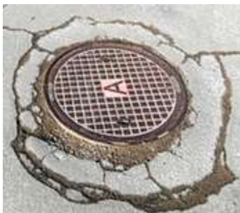
Skador runt brunnsbetäckning
