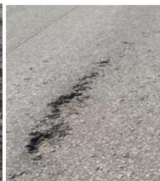
Mindre skada i asfalten
