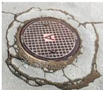
Skador runt brunnsbetäckning
