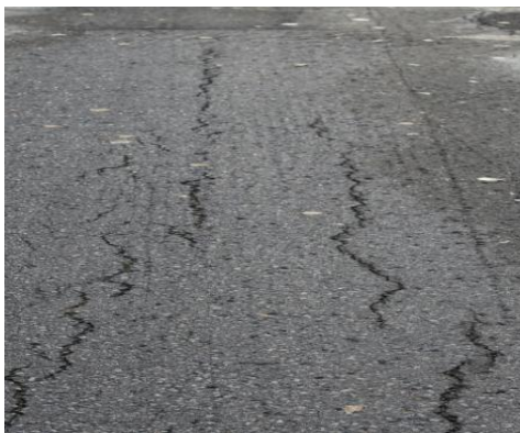
Tjälsprickor i beläggningen
