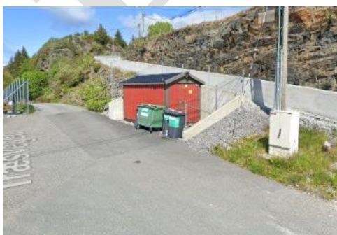
Figur 46, Trafo ved Træsvegen
