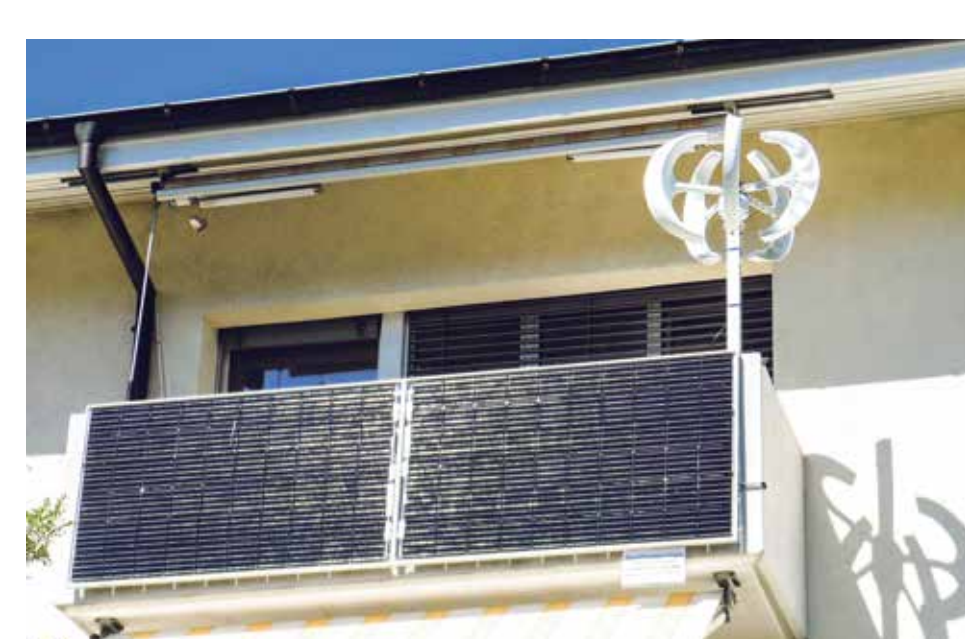
Une installation photovoltaïque de 600 watts fonctionnant toute l'année peut couvrir 10 % des besoins en électricité d'une famille de quatre personnes.
