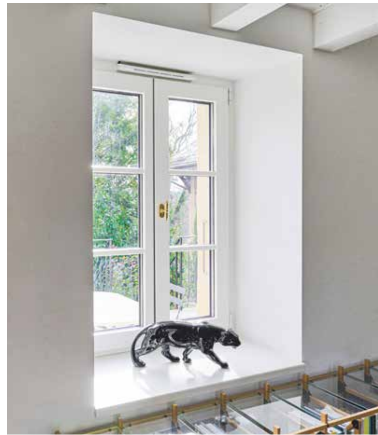
Protection optimale avec 30 cm d'isolation en plus et des fenêtres à triple vitrage surmontées d'une aération.
