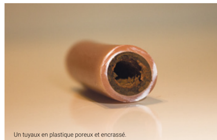
Un tuyau en plastique poreux et encrassé.
