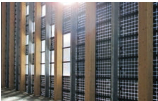
STANDARDMODUL: TALSTATION KLEIN MATTERHORN
