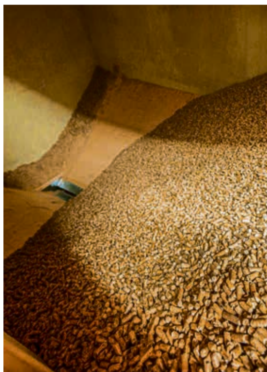
Auch das ist neu: Pelletheizung statt Ölheizung.
