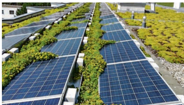
Sehen zwar schön aus, beeinträchtigen jedoch den Energieertrag von PV-Anlagen: schattenwerfende Pflanzen auf Solarpanels. (Foto: Contec)
