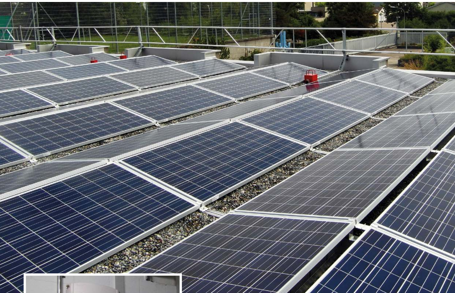
Moduli fotovoltaici con orientamento est/ovest posati su un tetto piano
