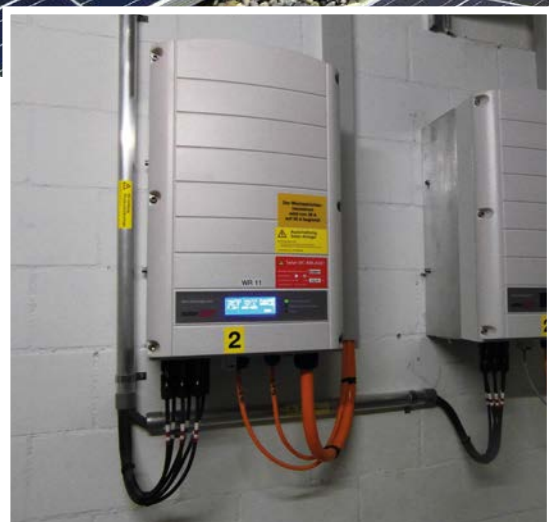
Inverter nello scantinato di un edificio
