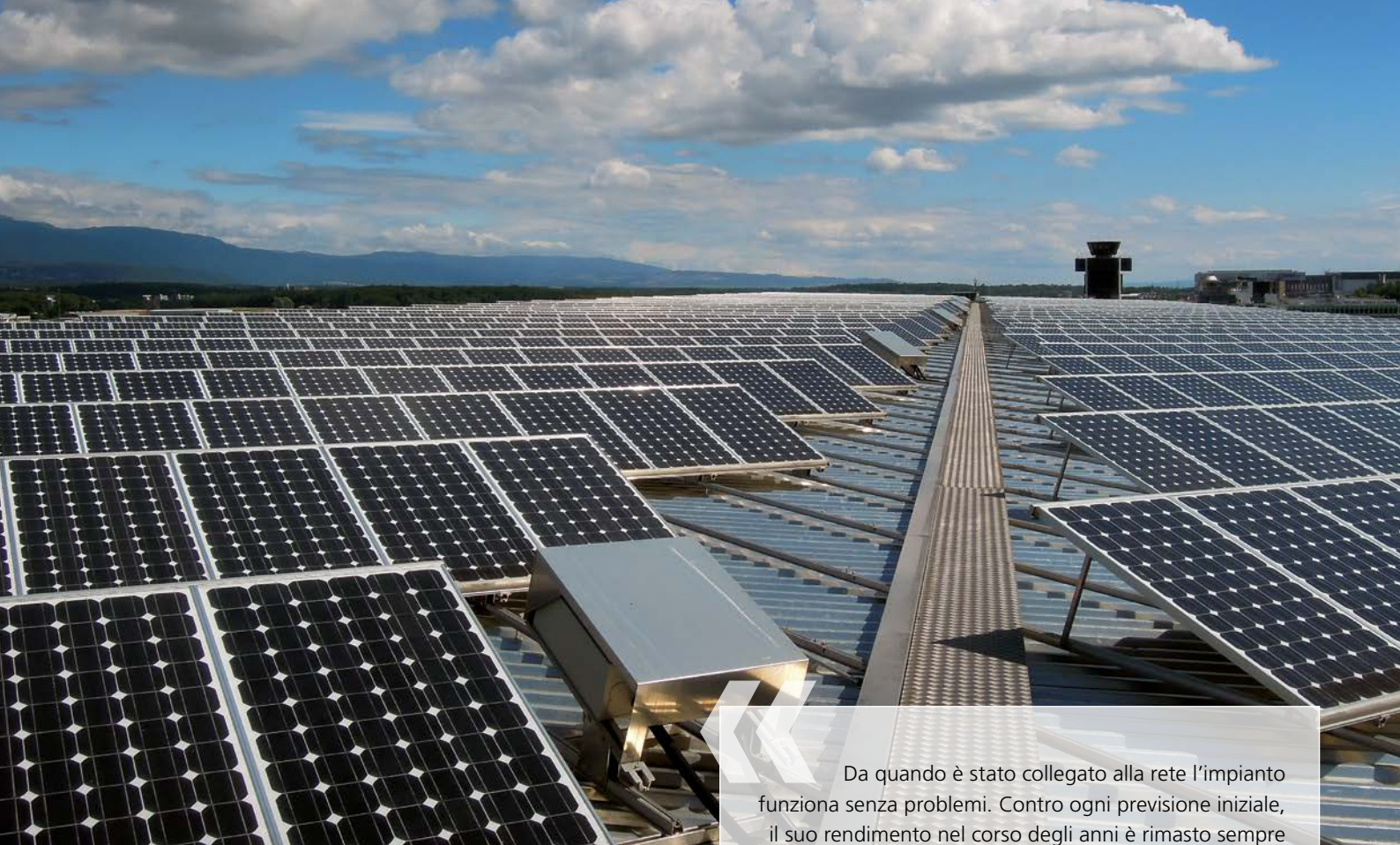
Impianto FV di Edisun Power all'aeroporto di Ginevra
