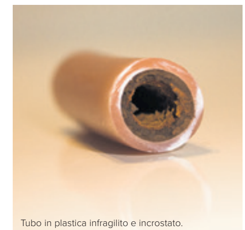
Tubo in plastica infragilito e incrostato.
