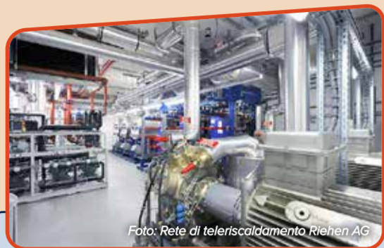
Foto: Rete di teleriscaldamento Riehen AG
