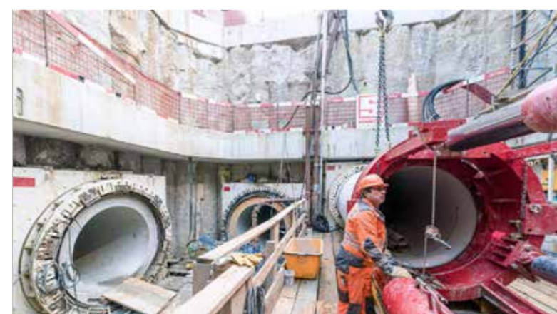
Sotto la città di Zugo: nel 2017 si è inaugurata la rete di riscaldamento e raffreddamento Circulago e nel 2020 è entrata in funzione la prima centrale di quartiere.
