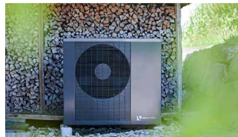
Pompa di calore aria-acqua Foto: Gerry Nitsch
