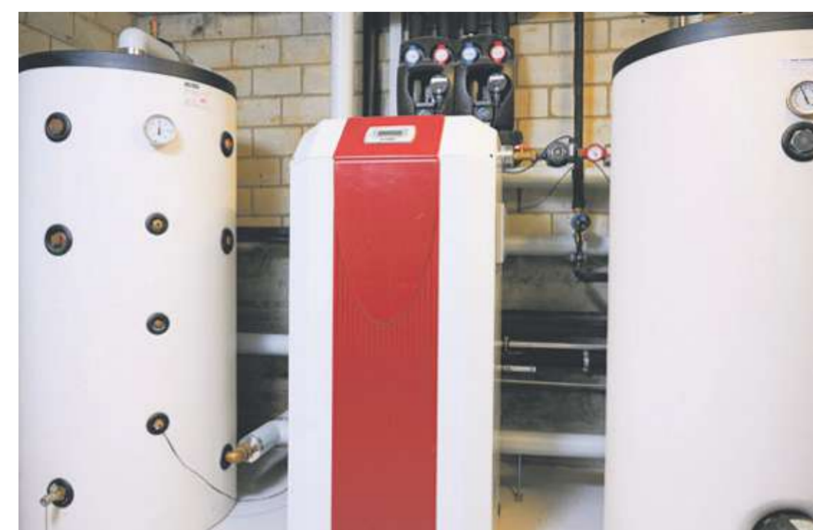
Aus Solarstrom wird speicherbare Wärme: Eine Wärmepumpe (Mitte) und gedämmte Wassertanks machen es möglich.
