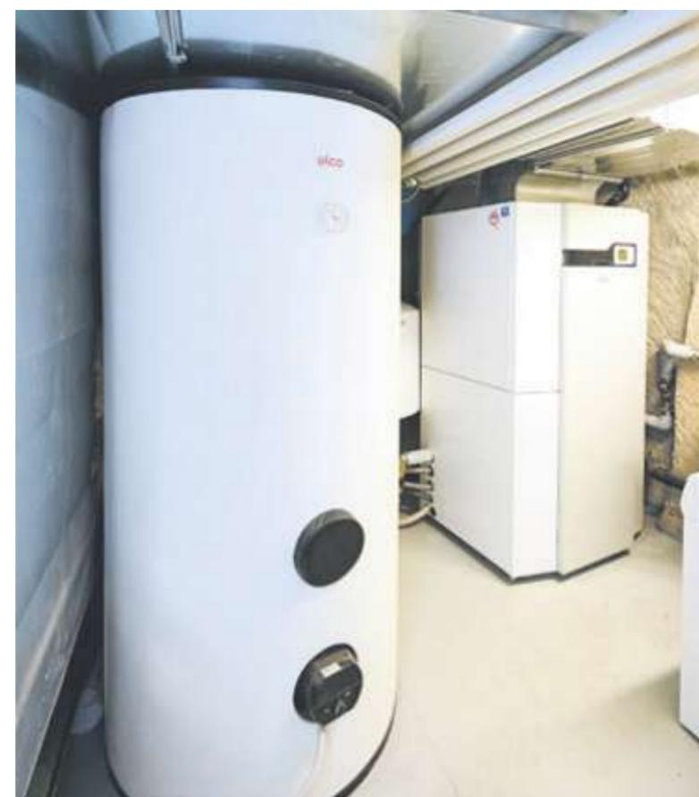
Das neue Heizsystem: eine innenaufgestellte Luft-Wasser-Wärmepumpe (rechts) mit Speicher für Solarthermie.
