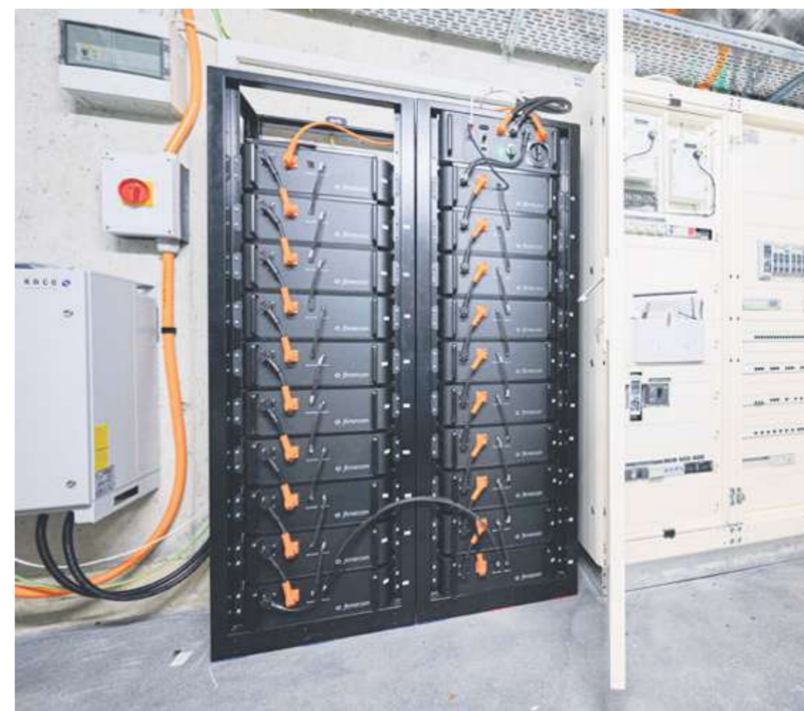
Diese grössere Batterie speichert Solarstrom, der auf einem Schulhausdach produziert wird.
