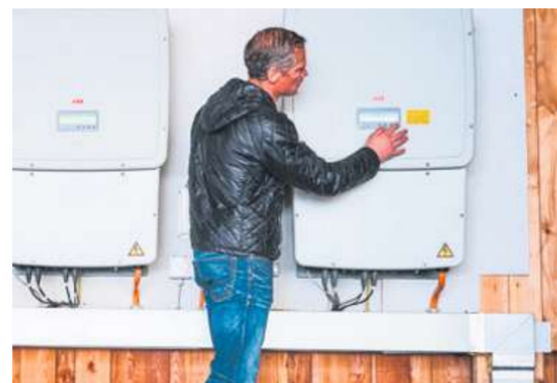
Wechselrichter: Hier kommen jährlich rund 77 000 Kilowattstunden Solarstrom zusammen.
