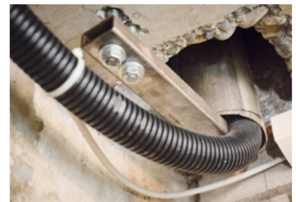
L'ancien conduit de cheminée sert aujourd'hui au passage des câbles pour l'installation solaire.
