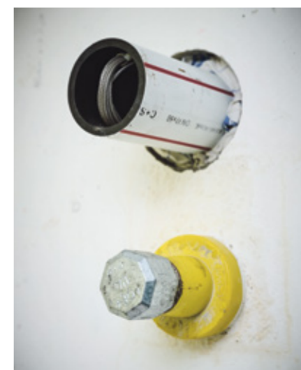
Le raccord de gaz abandonné (ci-dessous) et la conduite d'alimentation prête pour la borne de recharge électrique.
