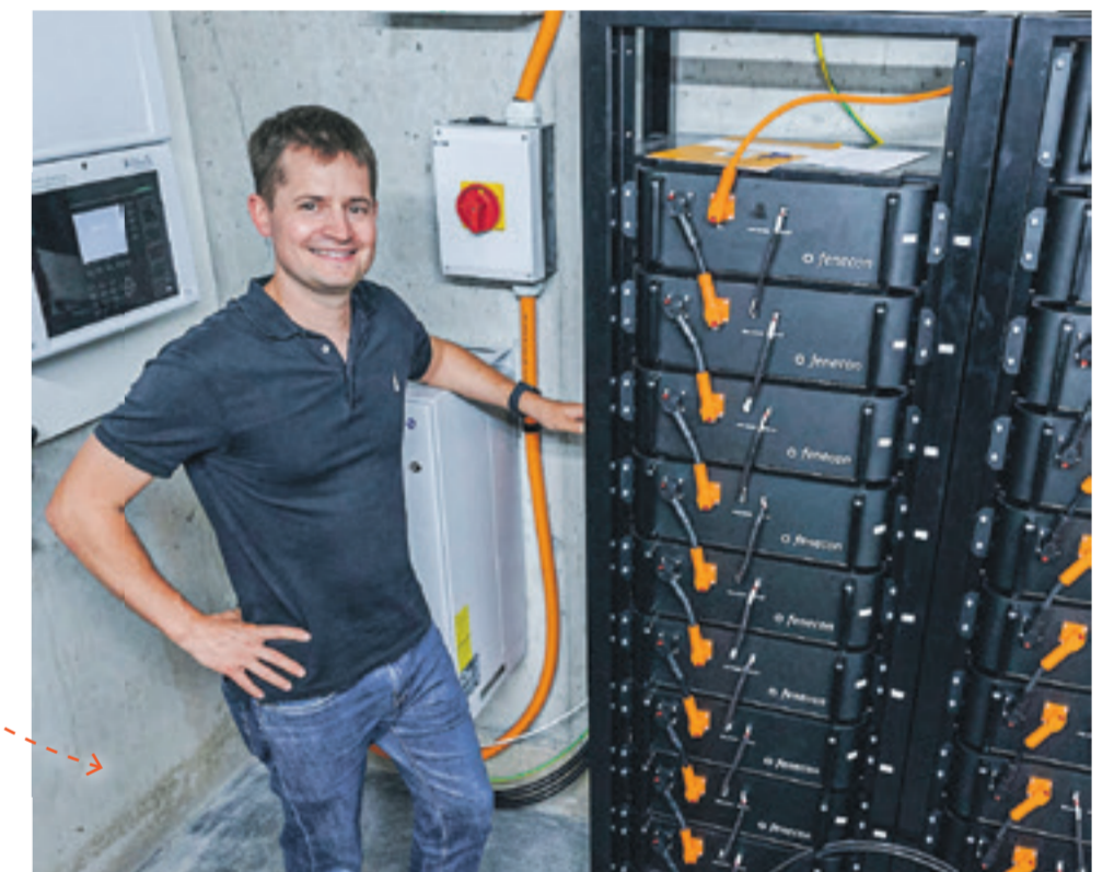
Davide Rivola, Projektleiter der Fachhochschule SUPSI, mit Quartierbatterie.
