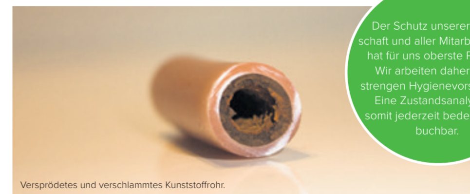
Versprödetes und verschlammtes Kunststoffrohr.
