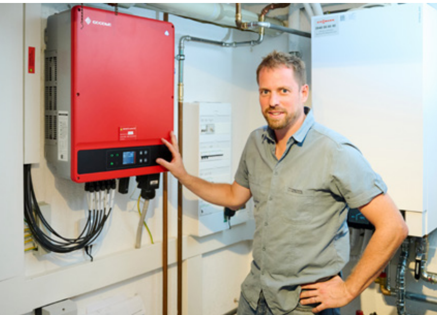
Alberto Conelli nel locale tecnico: con il quadro rosso di comando dell'impianto fotovoltaico e quello della pompa di calore.
