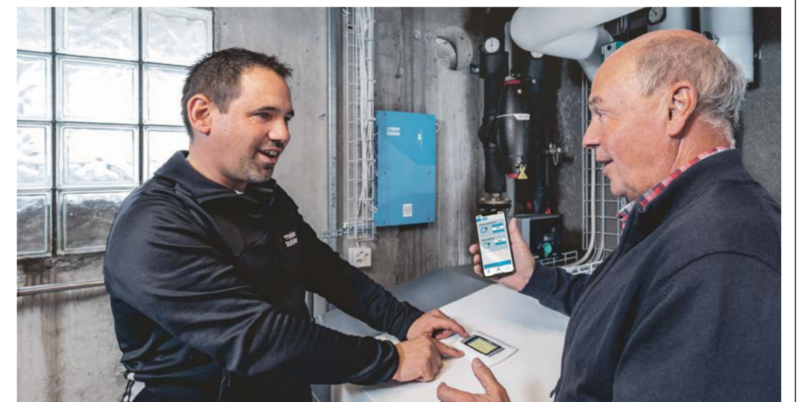
Christoph Wiesner (a sinistra), tecnico di servizio da Meier Tobler, spiega a Paul Jossen, rappresentante della comunità di comproprietari, il funzionamento di SmartGuard e dell'app Meier Tobler.
