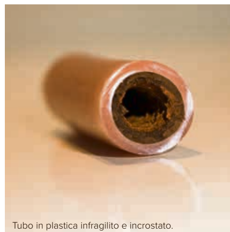
Tubo in plastica infragilito e incrostato.
