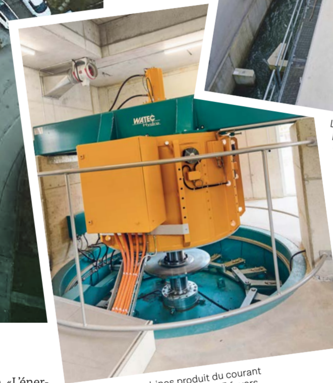
Cette salle des turbines produit du courant couvrant les besoins annuels de 55 foyers.
