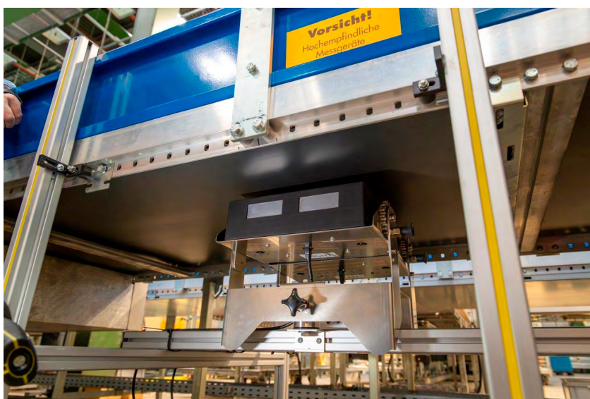
Figure 18 : Scintillateurs installés sous le tapis roulant pour mesurer le rayonnement
