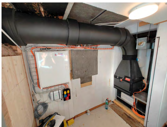
Figure 22: Nouvelle station de mesure du Jungfrauoch avec la ligne d'aspiration et la chambre de collecte à l'intérieur de la station
