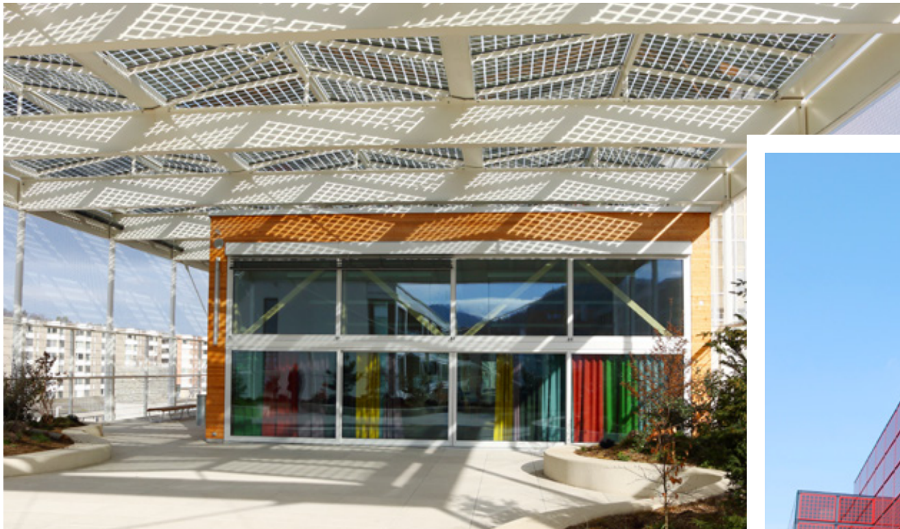
Sur le toit de l'école primaire Allmend à Zurich-Wollishofen, un terrain de jeu utilisable par tous les temps a été complété par une installation photovoltaïque intégrée.
