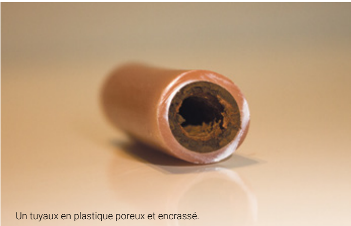
Un tuyau en plastique poreux et encrassé.
