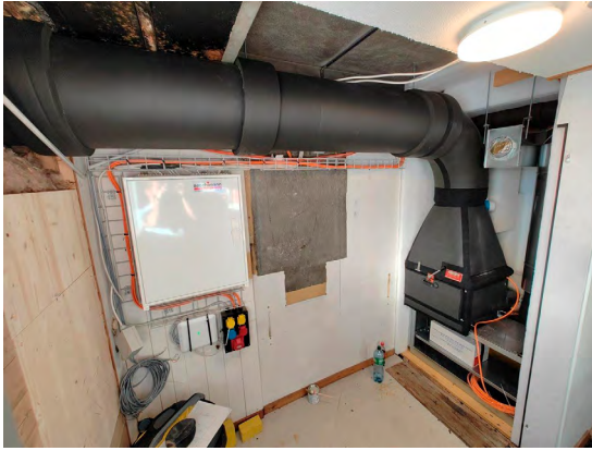
Abb. 22: Die neue Messstation auf dem Jungfrauoch von innen, mit Ansaugleitung und Sammelkammer
