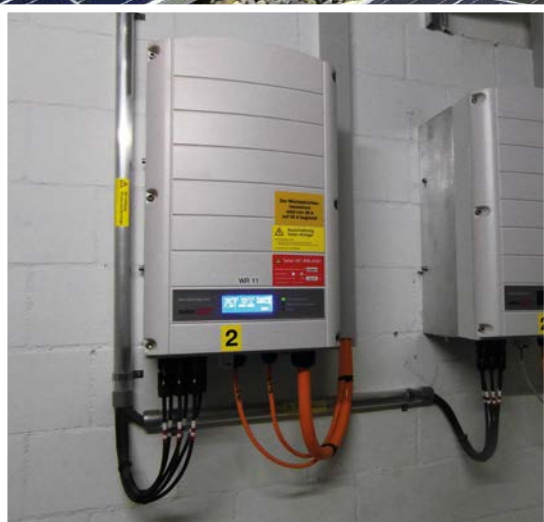
Onduleurs au sous-sol
