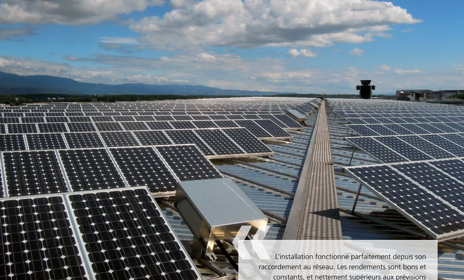
Installation PV d'Edisun Power à l'aéroport de Genève
