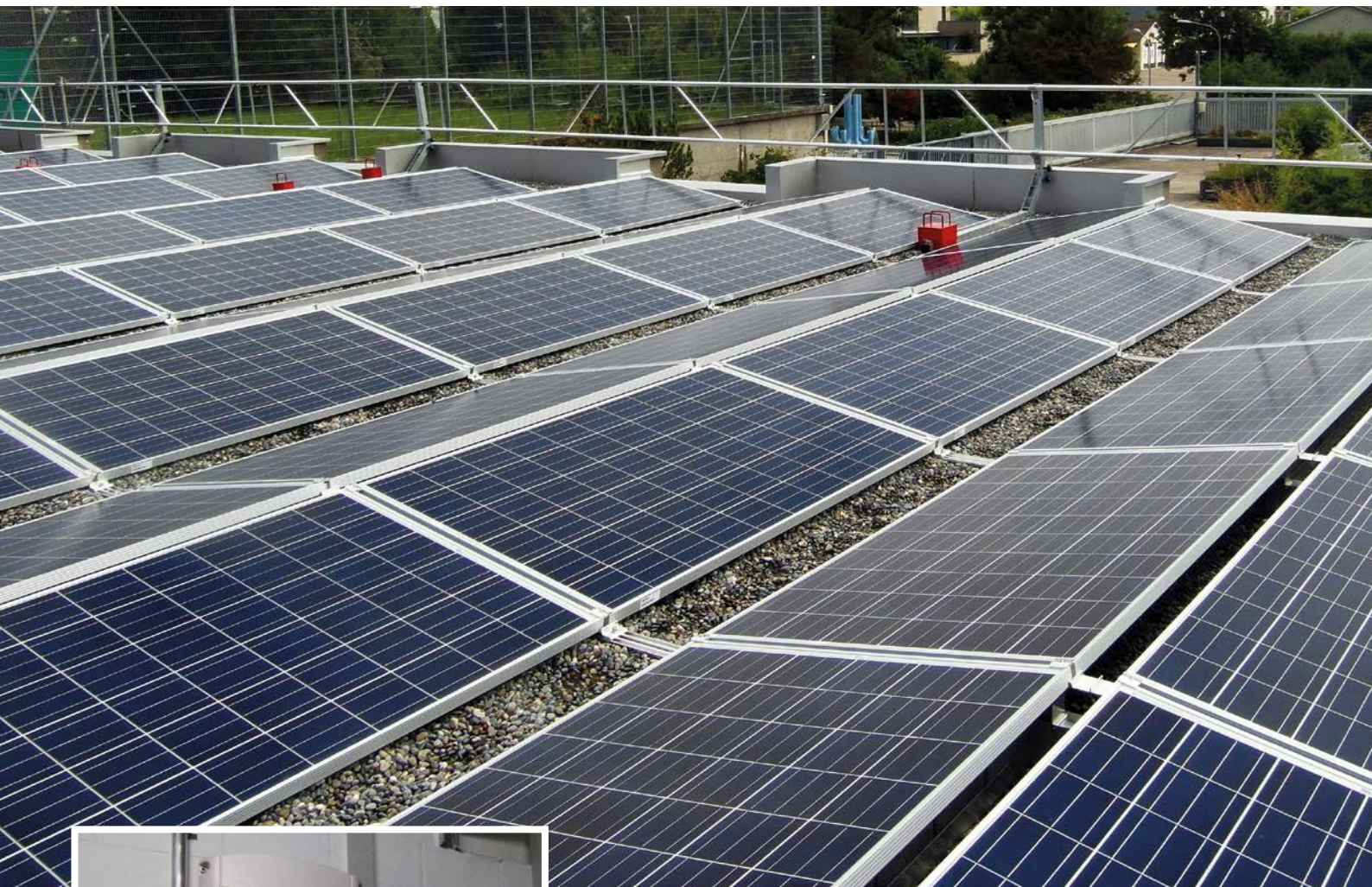
Modules solaires orientés est/ouest sur un toit plat
