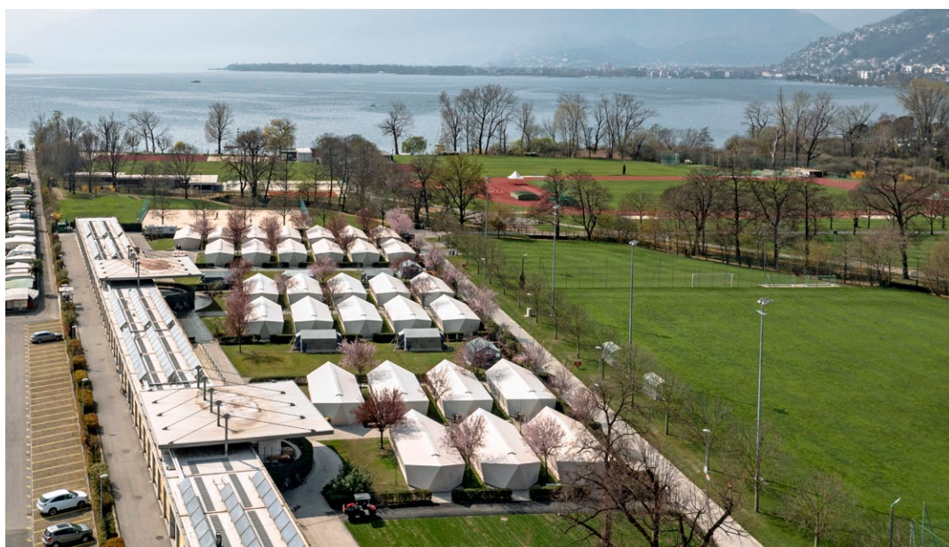
Impianto di energia solare termica sull'edificio che ospita il campeggio del CST (foto: Marcelo Villada Ortiz)
