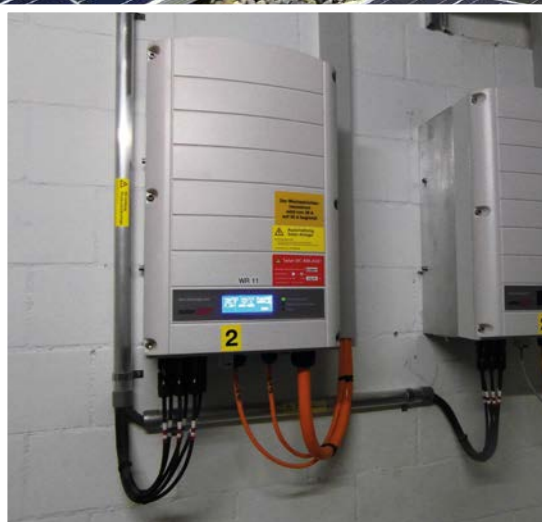
Wechselrichter im Kellergeschoss
