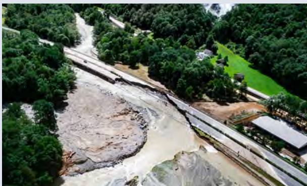
Tratto distrutto dell'autostrada A13 tra Lostallo e Soazza (GR). Foto: Samuel Golay / Keystone / Ti-Press
