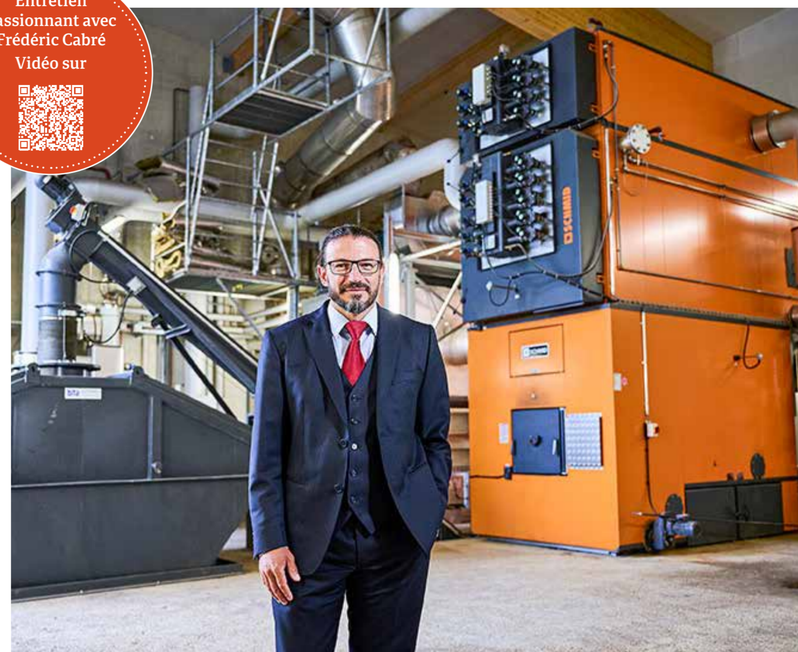
«Tout le monde aide à faire avancer le village»: Frédéric Cabré, président de la coopérative de chauffage à distance de La Brévine, dans la centrale thermique.
