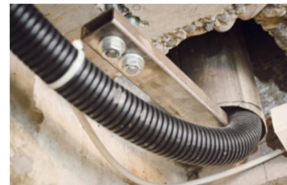
Oggi, i cavi dell'impianto solare passano attraverso il vecchio camino.
