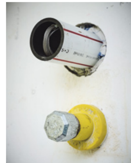
L'allacciamento del gas chiuso (sotto) e la linea di alimentazione predisposta per la stazione di ricarica elettrica.
