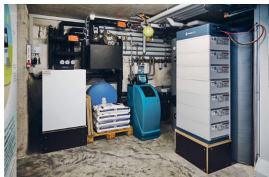
Il locale tecnico è nel piano interrato, dove sono installate pompa di calore e accumulatore di elettricità e di calore.
