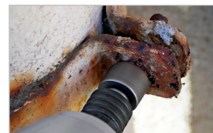
Démontage vis rouillée Rusted screw dismantling
