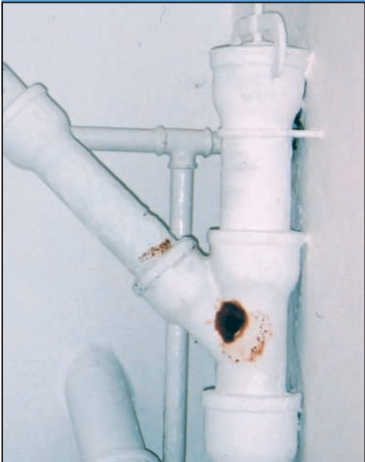
El orín es indicador de que hay condensación en este tubo de drenaje. Deberá aislarse el tubo para evitar la condensación.
