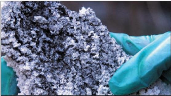
Moho creciendo en un trozo de baldosa de techo.
