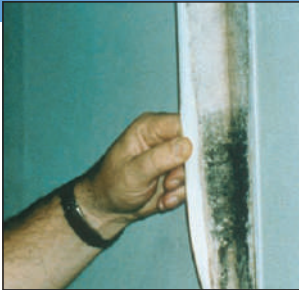
Moho creciendo detrás de un empapelado.
