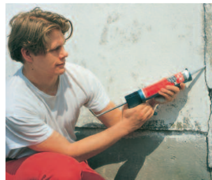
Putzrisse können mit PCI Adaptol plasto-elastisch geschlossen werden.
