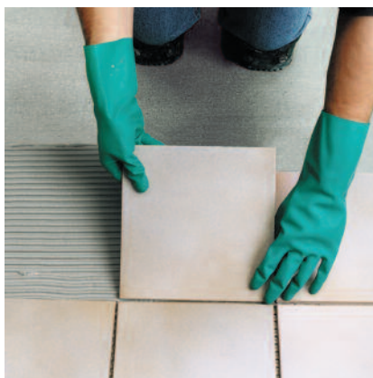
5. ... bzw. der Entkopplungsplatte PCI Polysilent überarbeitet werden. Auf dieser Abdichtungs- bzw. Entkopplungsschicht können nach deren Trocknung Fliesen und Platten verlegt werden (siehe Tabelle).
