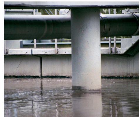
Sicheres Schließen von horizontalen und vertikalen Anschluss- und Bewegungsfugen in einer Kläranlage mit PCI Escutan TF.
