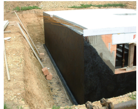
Abdichtung einer Kelleraußenwand aus Beton mit PCI Pecimor 2K. Geschmeidig-leichtes Verarbeiten durch Polystyrolfüllung.
