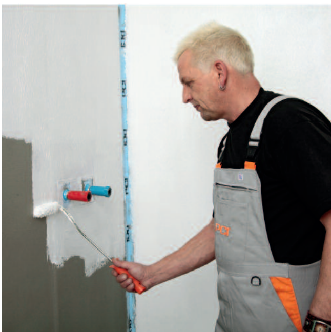
5. Zweite Schutzschicht mit PCI Lastogum (weiß) nach einer Ablüftezeit von ca. 1 Stunde aufbringen. Ein Durchscheinen des 1. Auftrags mit PCI Lastogum (weiß) ist zu vermeiden, erforderlichenfalls nochmals überarbeiten.
