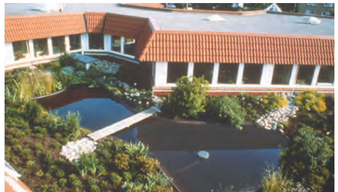
Abb. 53: Begrünte und begehbare Dachterrasse mit Anstau-bewässerung in Folienteichen über einer Umkehrdachkonstruktion mit ganzflächiger Kiesdränschicht.
