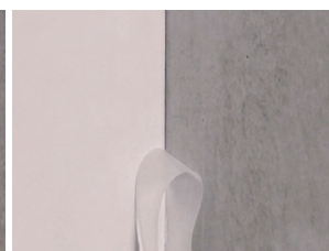
Abb. 15: mangelfreie und herstellerkonforme Anschlussfuge
