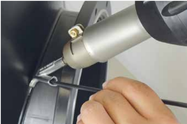
Behälter- und Apparatebau
