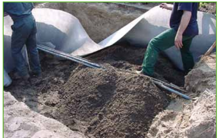
Auch um Kabel herum lässt sich RootBarrier® vorzüglich verwenden.
