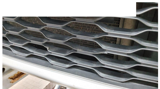
Stoßfänger vorne Luftführung Mitte unten beschädigt - erneuern - erneuern Stoßfänger vorne Luftführung Mitte unten beschädigt (DEKRA)
