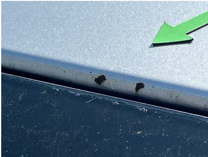
Dach (Lackschaden, Rost)
