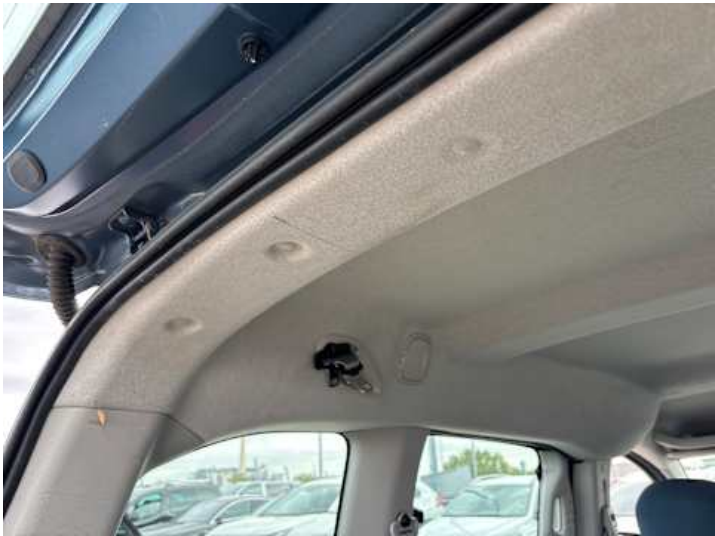
Innenraum (Diverse Schäden, Kratzer)
