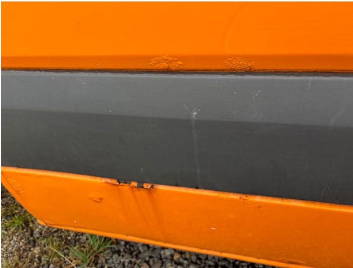
Türe hinten rechts (Rost)
