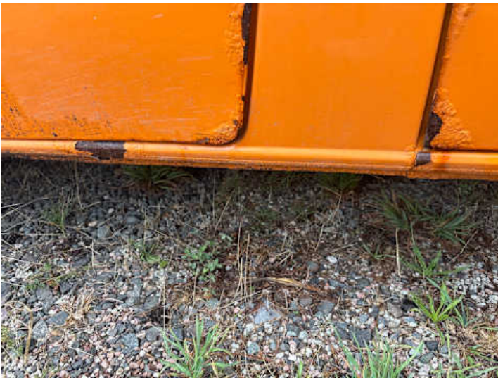
Schweller links (Rost)
