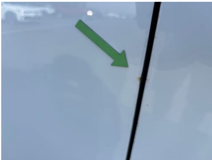
Türe hinten rechts (Lackschaden, Rost)
