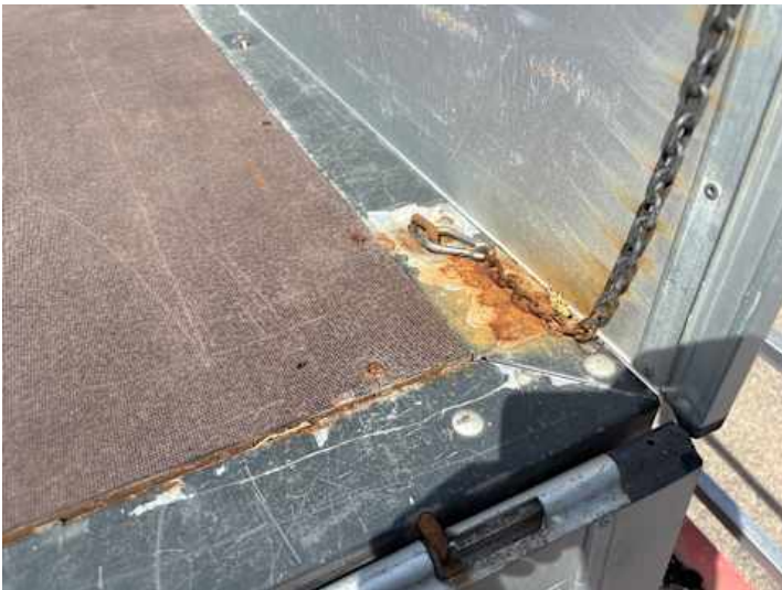
Innenraum (Diverse Schäden)
